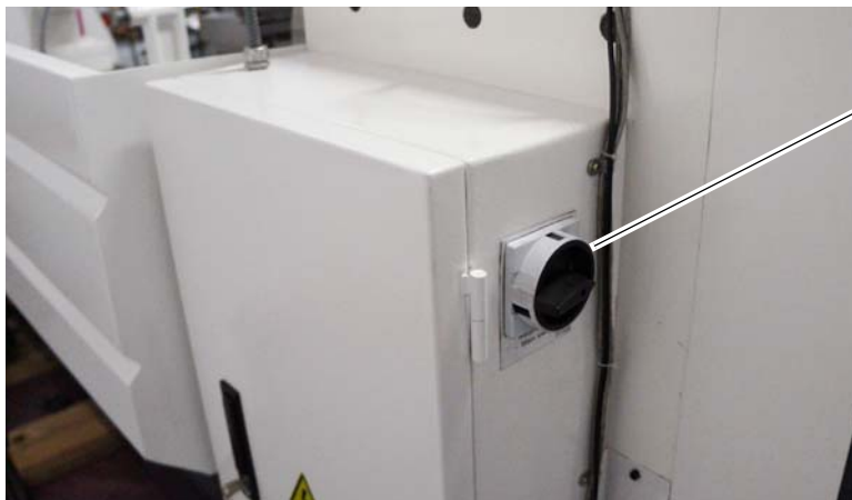
Img.1-1: Main switch
